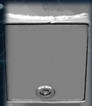
Detalle caja de conexiones
